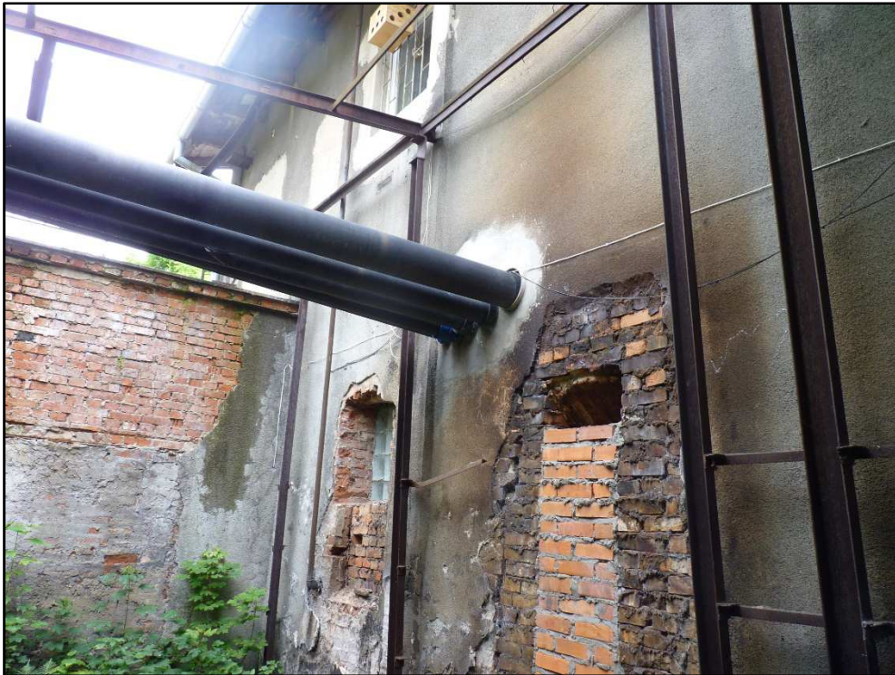
Fotografia 34. Fragment zachodniej ściany budynku – w elewacji widoczne liczne ubytki, stanowiące potencjalne miejsca do zakładania gniazd przez ptaki. W górnej części fotografii, przy oknie powieszono karmnik dla ptaków. Korzystają z niej sikory i wróble.
