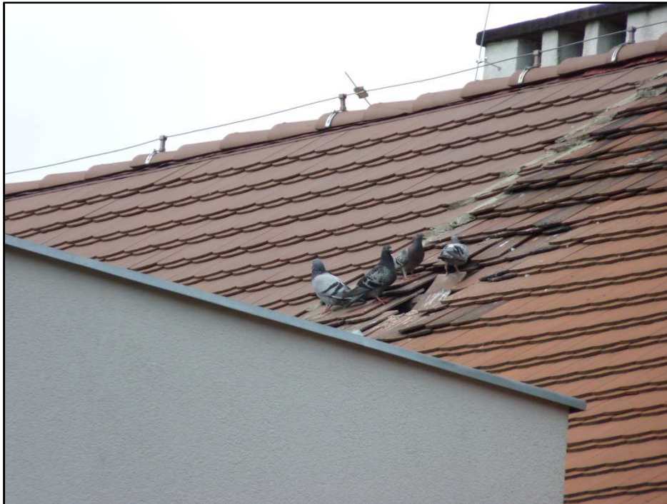
Fotografia 18. Widok na fragment nieszczęśliwego dachu budynku „B” – otwory, które gołębie miejskie dostają się do środka. Po lewej część nowego pokrycia dachowego, po prawej niewyremontowana część dachu na budynku „B”.
