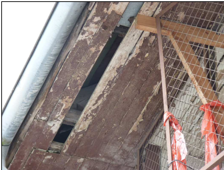
Fotografia 24. Jedna ze szczelin w dachu budynku „B”. Otwór, przez który dostają się na strych, stanowiący ich siedlisko, gołębie miejskie.
