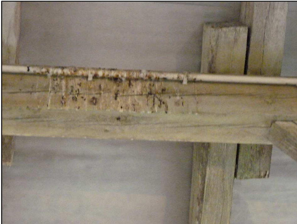
Fotografia 8. Jedna z belek pod dachem na strychu budynku „A”, na której zaobserwowano ślady przebywania ptaków – odchody gołębia miejskiego Columba livia forma urbana .
