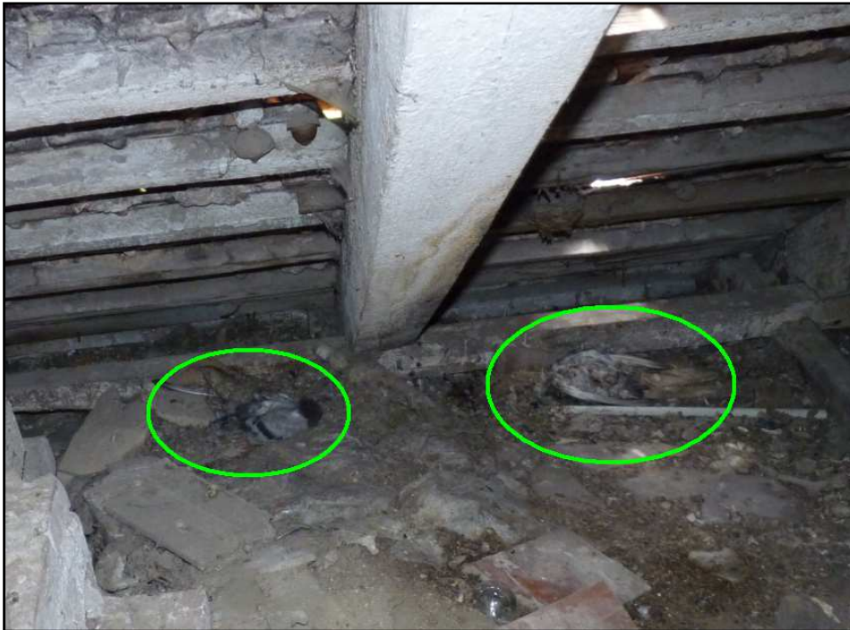
Fotografia 22. Dwa z czterech padłych osobników gołębia miejskiego w gnieździe, zlokalizowanym na strych budynku „B”.
