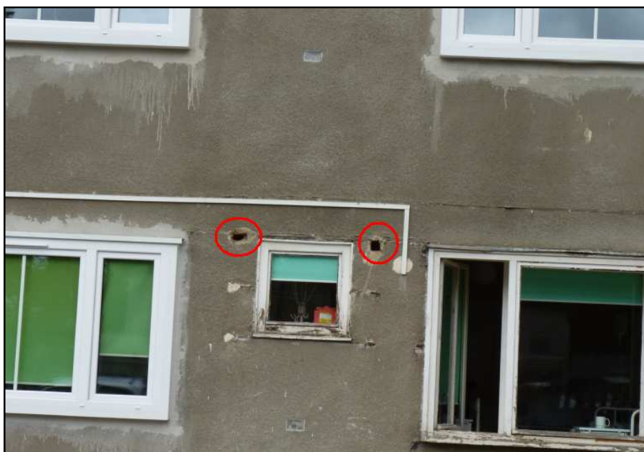
Fotografia 16. Dwa z spośród sześciu otworów w ścianie frontowej budynku „B” – potencjalne miejsca, w których gnieździć się mogą ptaki.
