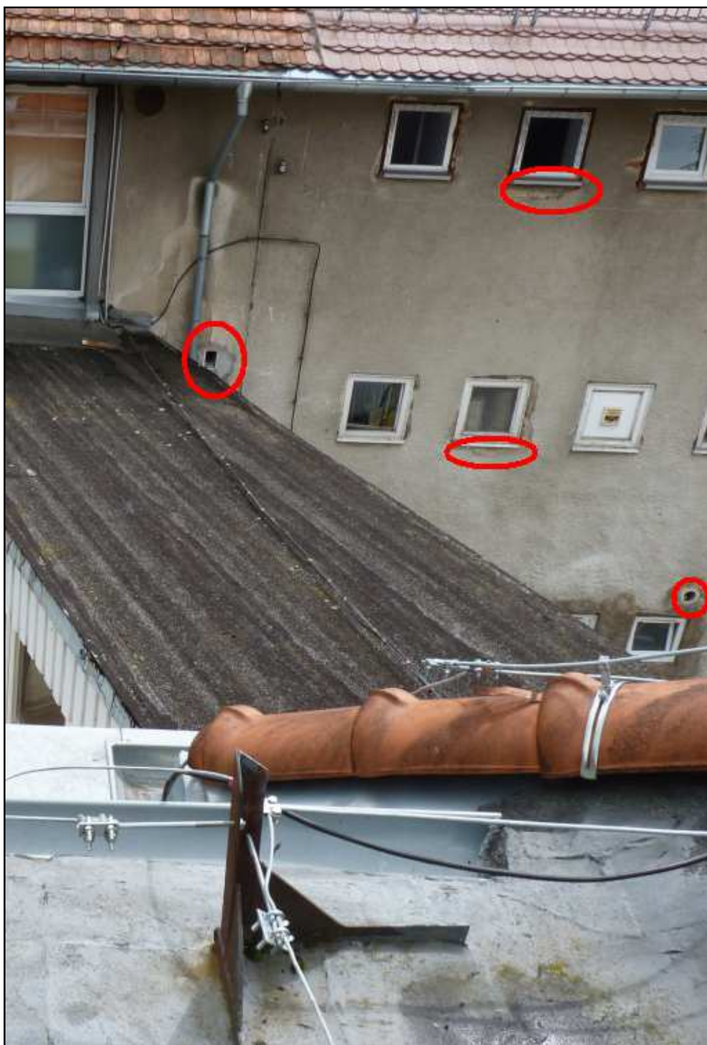
Fotografia 15. Niezabezpieczone otwory wentylacyjne w budynku „B” oraz szczeliny pod blaszanymi parapetami – potencjalne siedliska awifauny.
