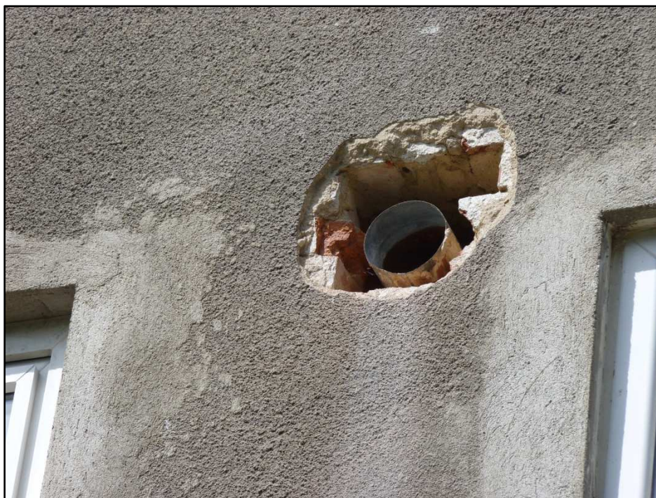
Fotografia 6. Ubytki w elewacji ściany wschodniej budynku wokół wylotu wentylacyjnego - potencjalne siedlisko dla drobnej awifauny.
