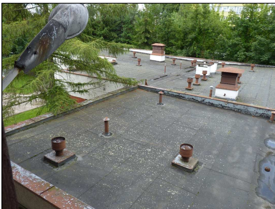
Fotografia 10. Widok na dach budynku „Rehabilitacji”, pokryty papą. Nie odnaleziono tu gniazd ptaków, jedynie ich ślady przebywania.
