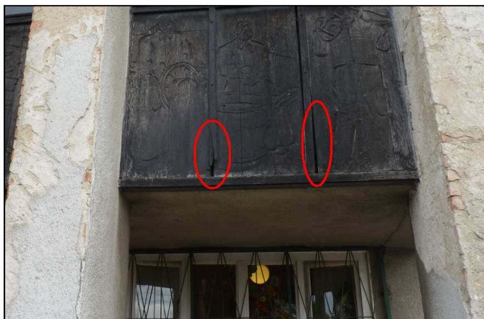
Fotografia 17. Dwie szczeliny w ścianie bocznej budynku „B” – potencjalne miejsca, w których gnieździć się mogą ptaki.
