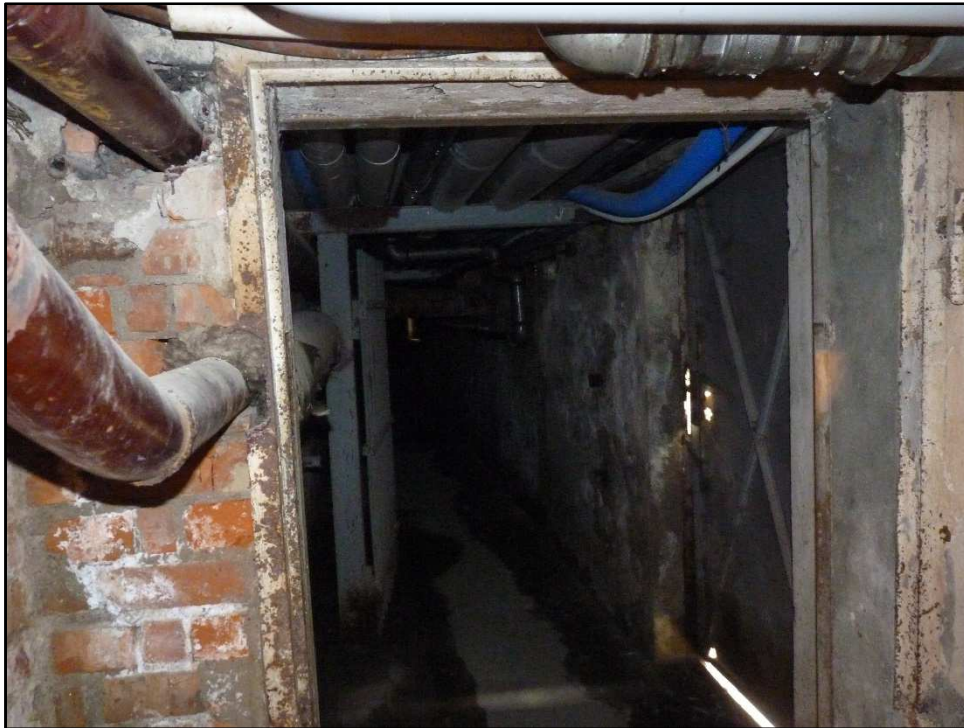
Fotografia 39. Jedno z pomieszczeń piwnicznych pod budynkiem „A”. Na zdjęciu po prawej widoczne szczeliny w obrębie blaszanych drzwi, przez które do środka mogłyby się dostać nietoperze.
