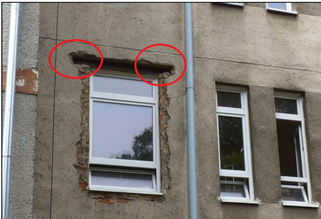
Fotografia 31. Ubytki w elewacji nad otworem okiennym w ścianie frontowej północno zachodniej budynku „G” – potencjalne siedliska ptasie.
