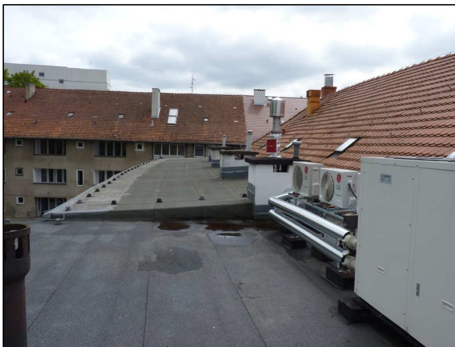
Fotografia 25. Dach budynku „C” – brak obecności gniazd ptaków, odnaleziono tu nieliczne ślady ich przebywania tj. odchody, pióra.
