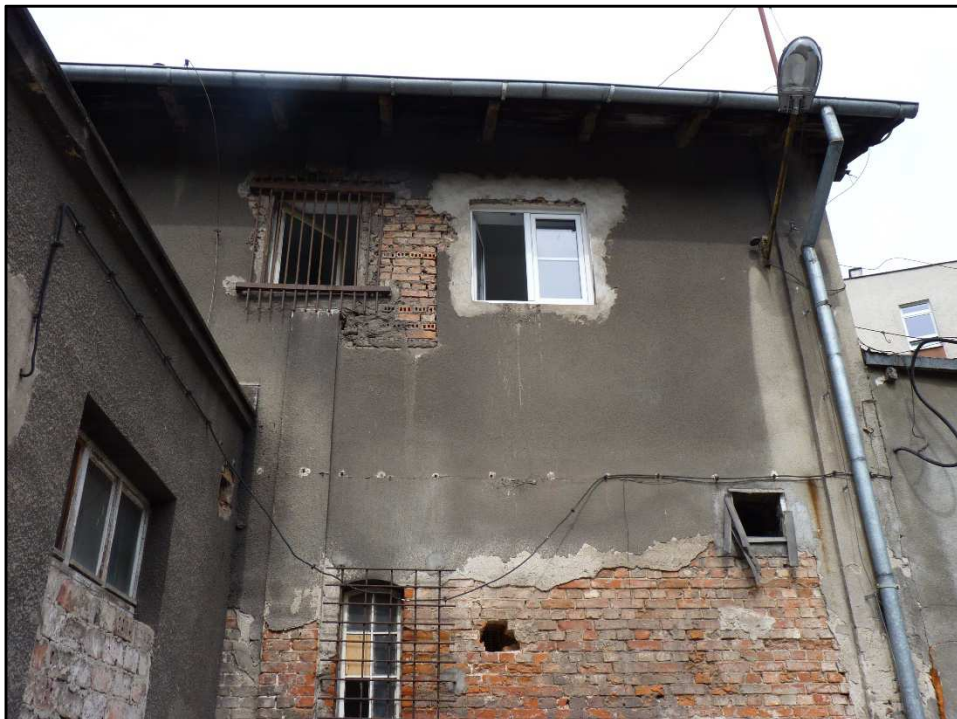
Fotografia 35. Widok w kierunku północnym na południowo wschodnią część ściany budynku. W elewacji widoczne liczne ubytki, oraz otwory, stanowiące potencjalne siedliska ptaków.
