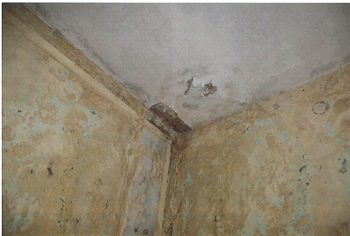
Zdjęcie nr 26 – Parter – jedno z pomieszczeń. Ściana i strop – widoczne liczne zawilgocenia oraz wykwity. Tynk w wielu miejscach odpada, jest złuszczone i porażony korozją biologiczną (grzyby pleśniowe).
