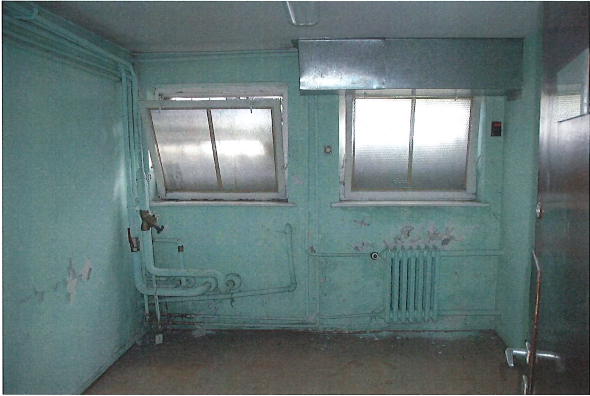
Zdjęcie nr 19 – Piwnica – jedno z pomieszczeń. Widoczne liczne zawilgocenia oraz ubytki tynku.
