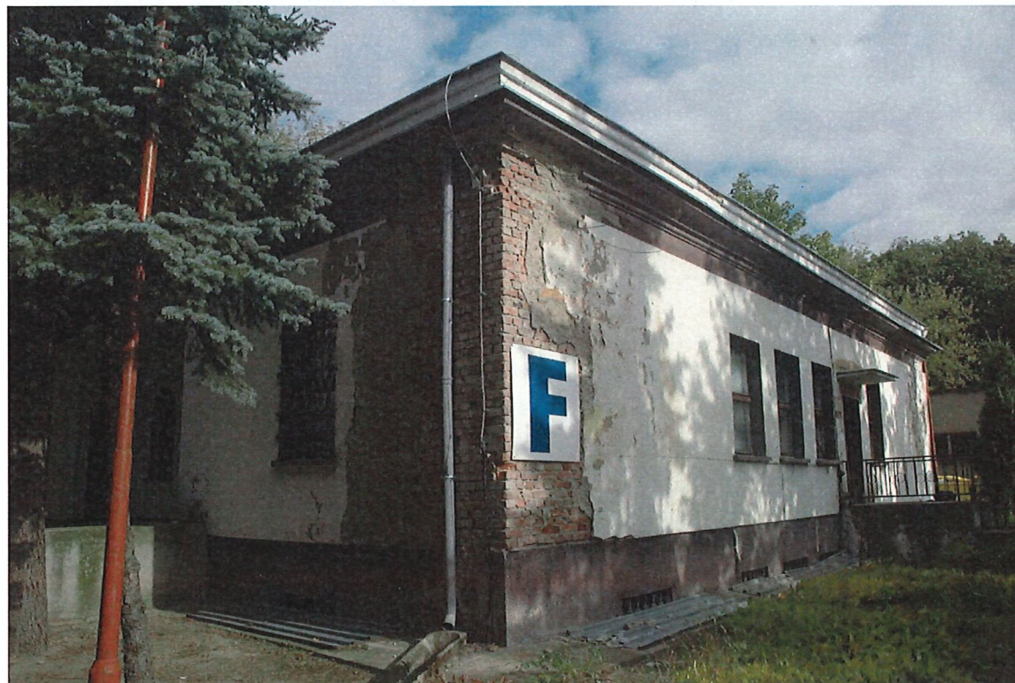
Zdjęcie nr 2 – Elewacja południowa. Widoczne zawilgocenia oraz ubytki tynku. Brak tynku na całej wysokości narożnika budynku. Zniszczony fragment gzymsu w narożniku.
