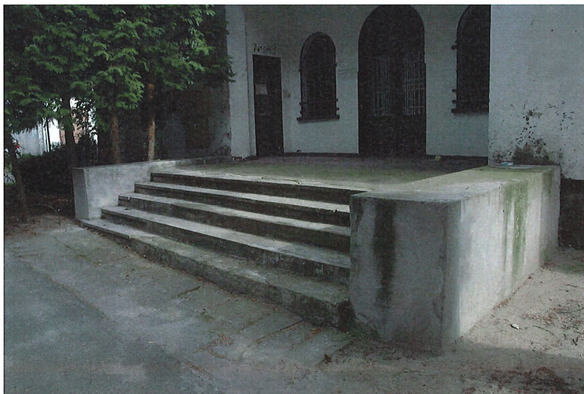
Zdjęcie nr 12 – Elewacja zachodnia. Widoczne liczne zawilgocenia, wykwyty oraz ubytki tynku. Zniszczone, zawilgocone, popękane ściany boczne schodów oraz ubytki w schodach.
