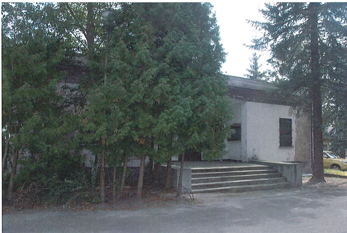
Zdjęcie nr 11 – Elewacja zachodnia. Widoczne liczne zawilgocenia oraz ubytki tynku. Po prawej stronie widoczny brak tynku na całej wysokości narożnika budynku.
