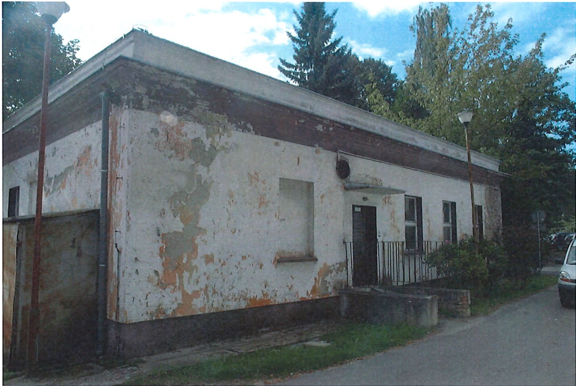
Zdjęcie nr 8 – Elewacja północna. Widoczne liczne zawilgocenia oraz ubytki tynku.
