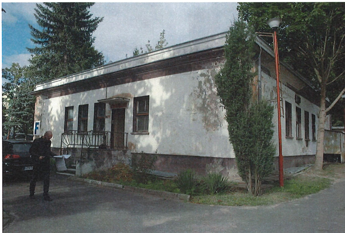
Zdjęcie nr 1 – Elewacja południowa – wejście do budynku. Widoczne zawilgocenia oraz ubytki tynku.
