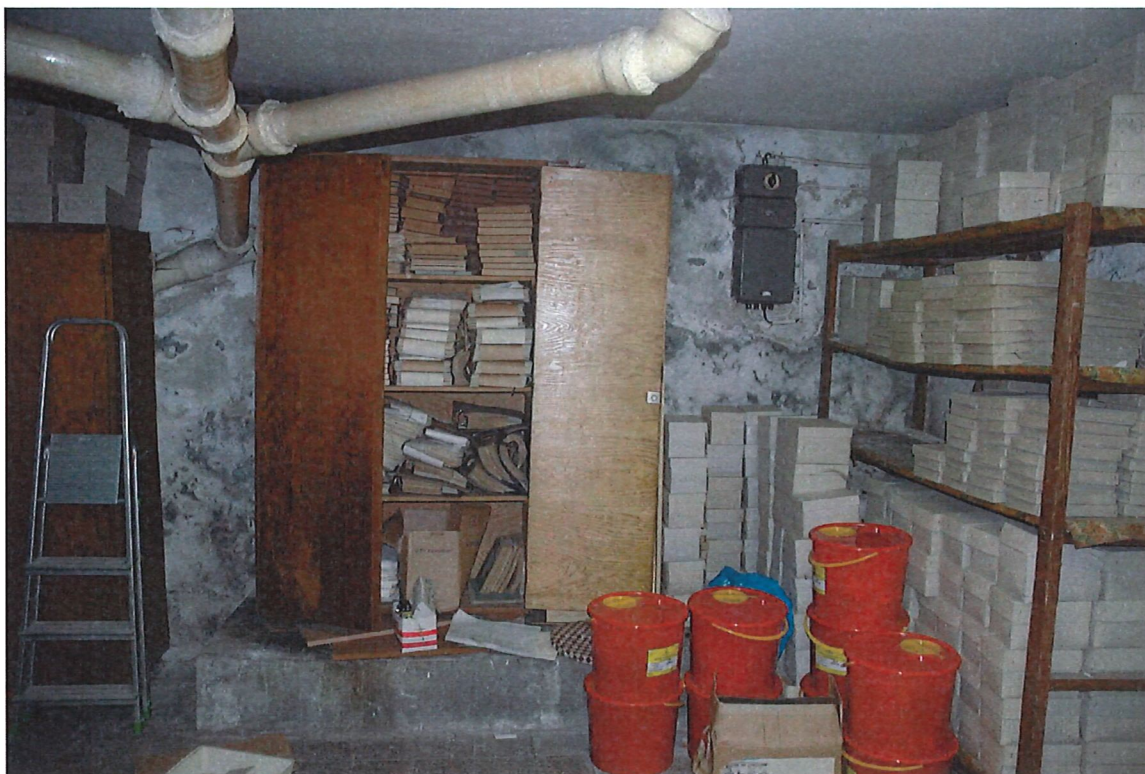
Zdjęcie nr 17 – Piwnica - archiwum. Widoczne liczne zawilgocenia, wykwyty oraz ubytki tynku.
