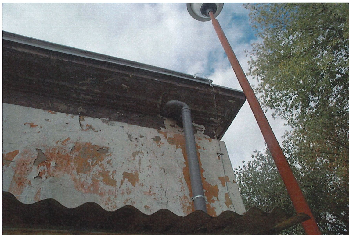
Zdjęcie nr 7 – Elewacja wschodnia. Widoczne zawilgocenia oraz ubytki tynku. Zniszczony fragment gzymsu. Przy narożniku rura spustowa.
