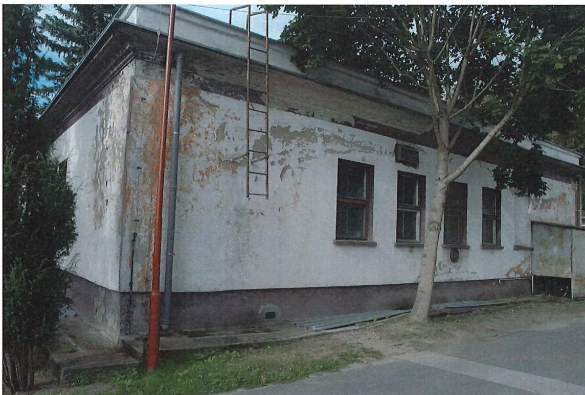
Zdjęcie nr 5 – Elewacja wschodnia. Widoczne zawilgocenia oraz ubytki tynku. Zniszczony spory fragment gzymsu. Po prawej stronie widoczna wiatka na agregat chłodniczy.
