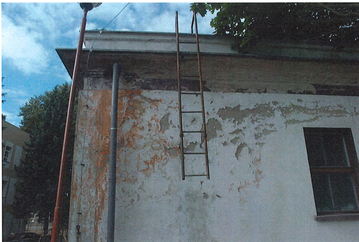
Zdjęcie nr 6 – Elewacja wschodnia. Widoczne zawilgocenia oraz ubytki tynku. Zniszczony spory fragment gzymsu.
