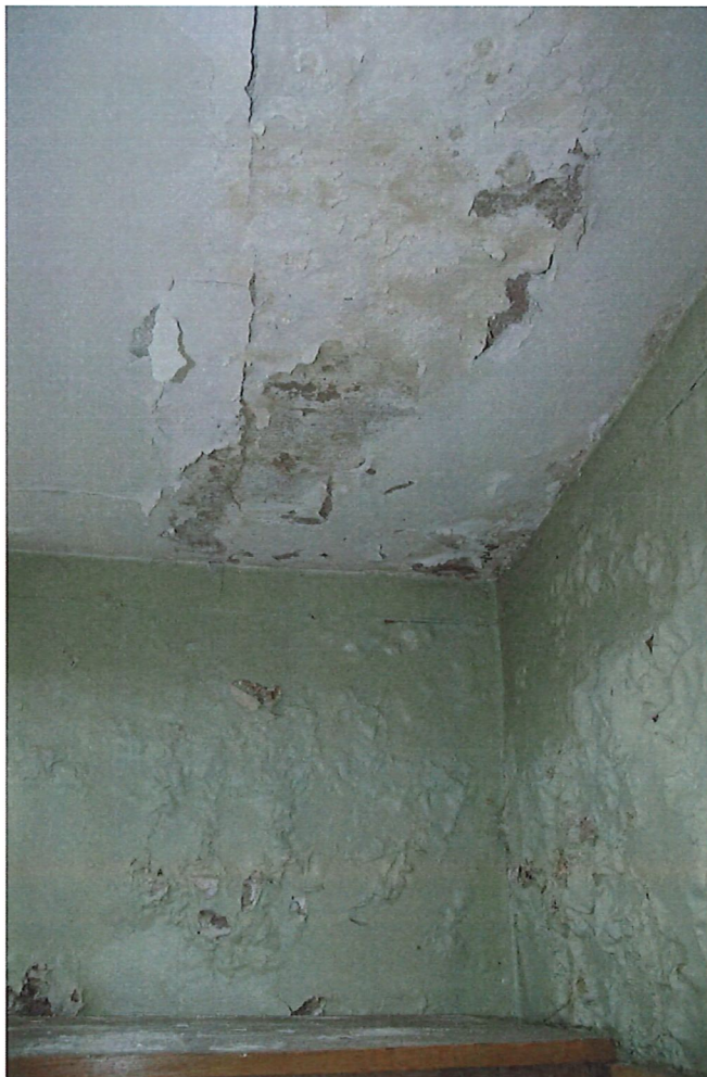
Zdjęcie nr 20 – Piwnica – jedno z pomieszczeń. Ściana i strop – widoczne liczne zawilgocenia oraz wykwyty. Tynk w wielu miejscach odpada, jest złuszczony i porażony korozją biologiczną (grzyby pleśniowe).
